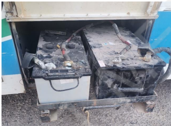
Figure 9 : batterie à changée
