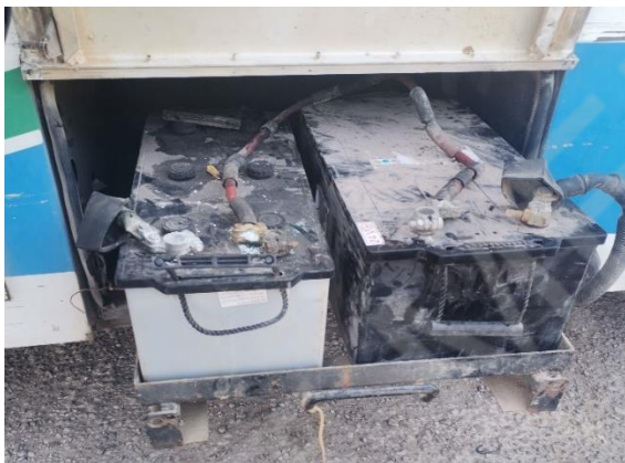
Figure 9 : Batterie à changer
